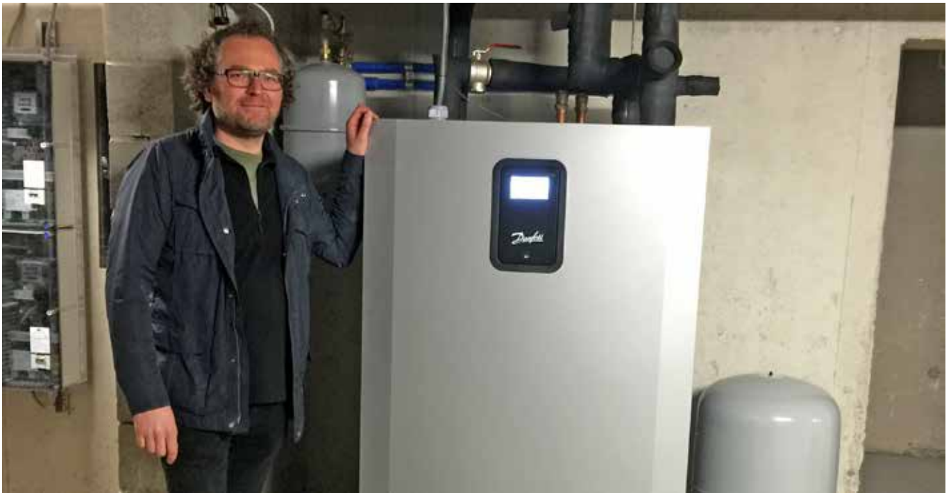
Luc Van de Velde bij de Danfoss DHP-M M warmtepomp
